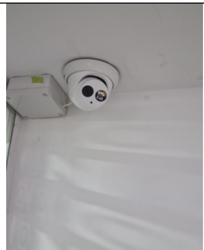
Foto 3: cámara de seguridad
