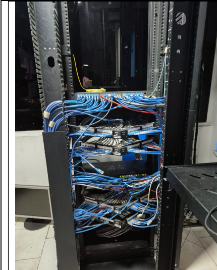
Foto 7: Rack ubicado en el centro de cómputo (master de producción).
