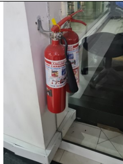
Foto 6: Extintor Manual contra fuego.
