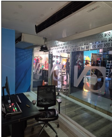
Foto 4: Aires acondicionados que controlan la temperatura del sitio.
