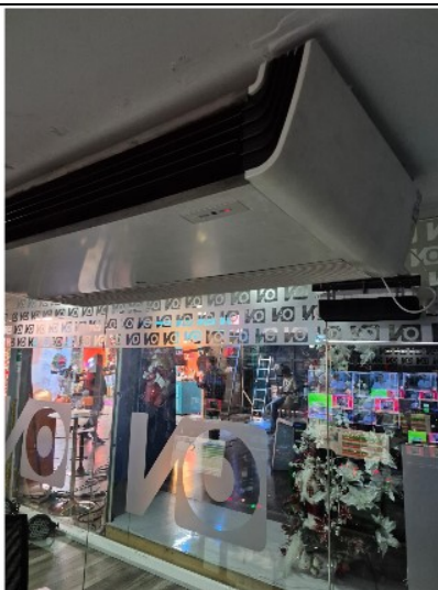
Foto 5: Aires acondicionados que controlan la temperatura del sitio
